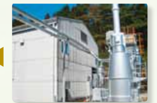
乾燥用ボイラー
